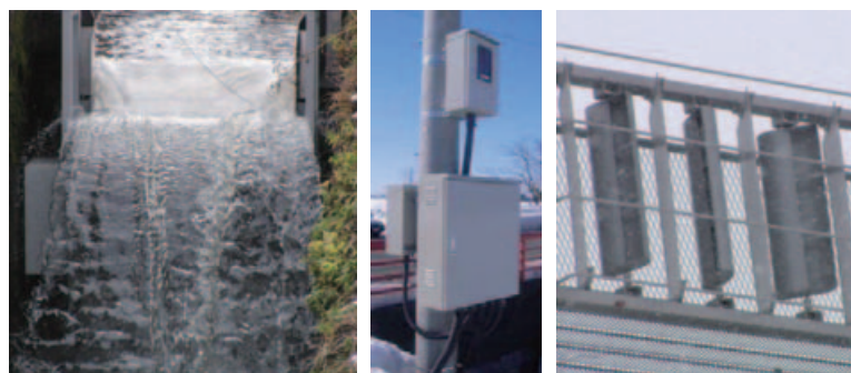
落差工に設置したマイクロ水車と系統連系用機器
