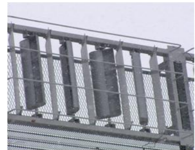
地吹雪による視程障害対策用風車
